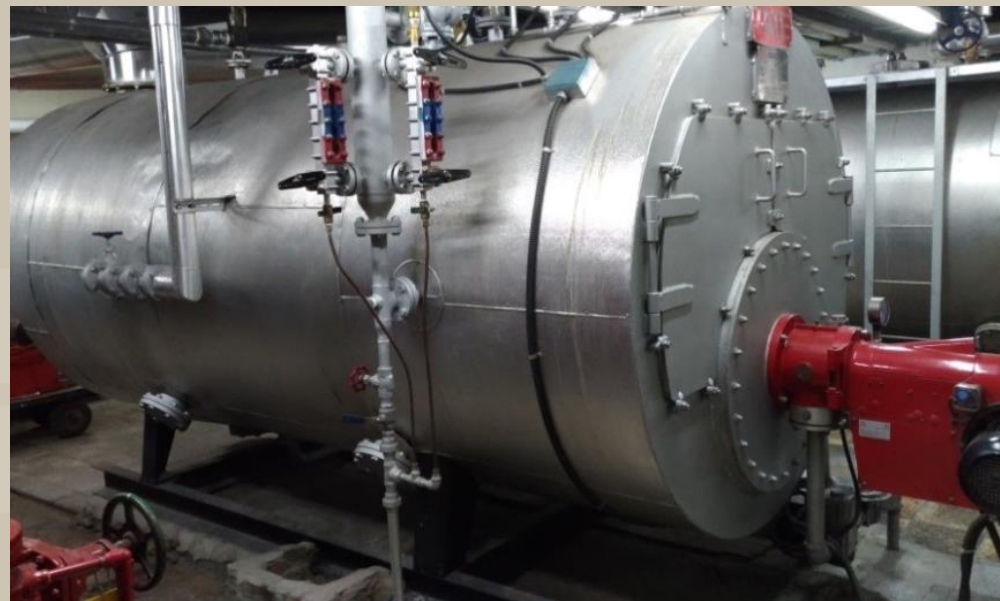
天然氣蒸汽鍋爐及空調主機圖
